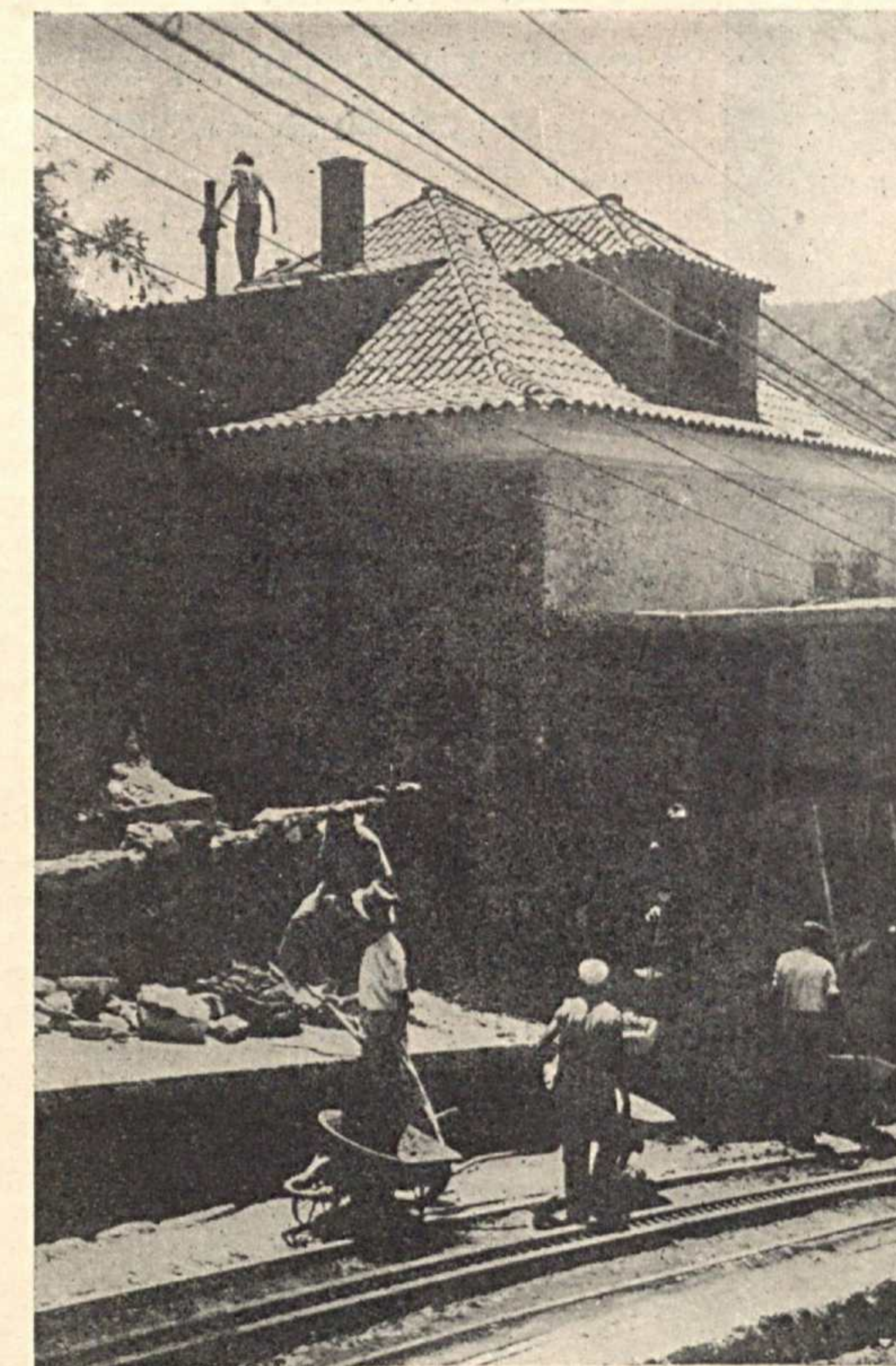
Outro aspecto das obras de construcção da nova estação da C. F. Carril Carioca, no Sylvestre
