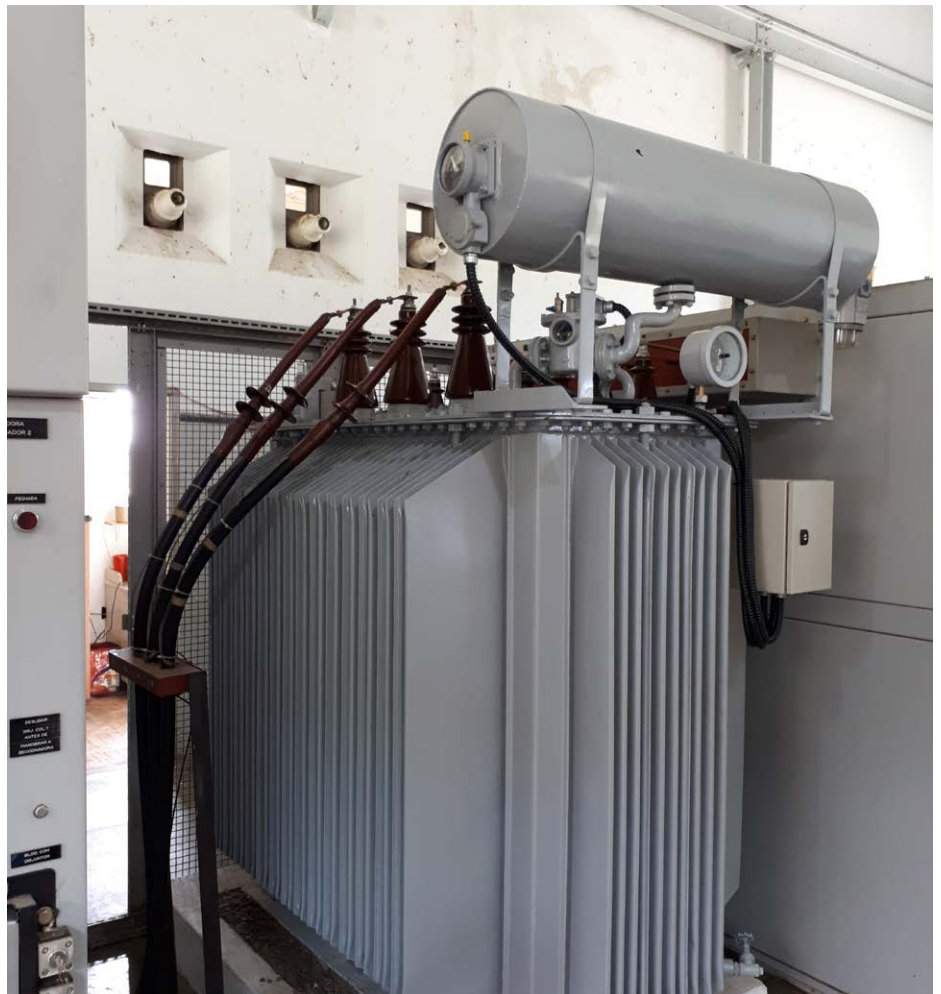
Após reforma, terceiro transformador ficou mais moderno e seguro
