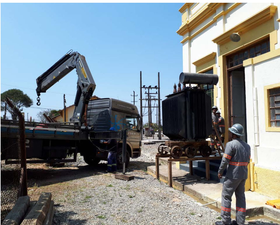
Transformador da subestação Santo Antônio do Pinhal passará por manutenção durante 45 dias
